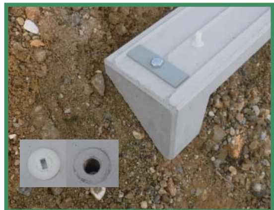
⑥インサートキャップを外しプレートをボルトで固定（杭の浮き上がりを抑止します）完成！
